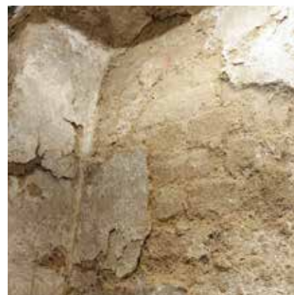
Kælderrum med fugt- og saltskader for sanering
